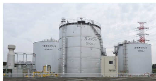
▲消化タンク・ガスタンク
